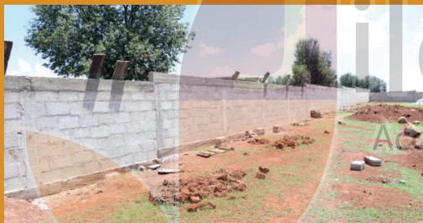
8. Construcción de barda perimetral en el Panteón Municipal. Ejido de Jilotepec Ayuntamiento 2019 - 2021
